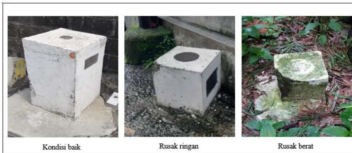
Gambar 3. Kondisi fisik pilar batas
