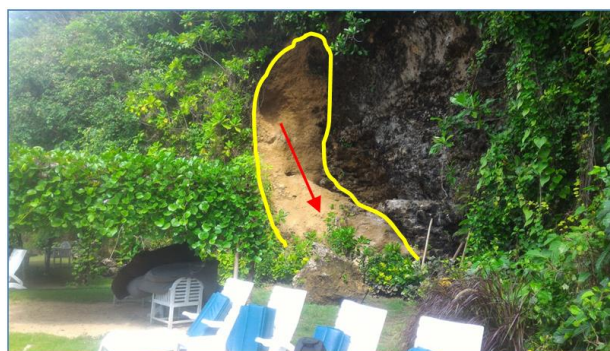
Gambar 3. Stasiun 1 Ditemukan Longsor Minor di Dinding Tebing (Sumber Pribadi, 2017)
