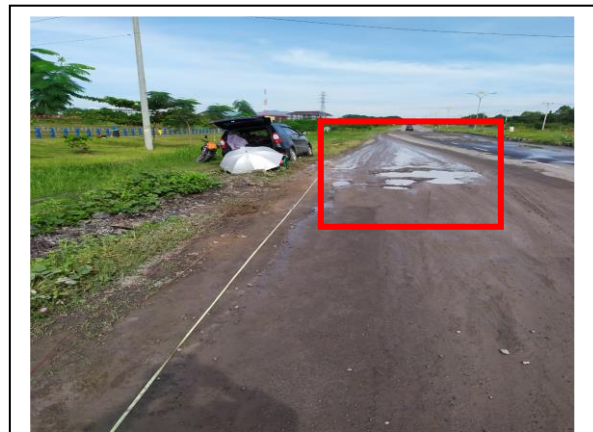
Gambar 1 Kerusakan yang muncul di Jalan Terusan Ryacudu, Lampung Selatan. (kotak warna merah menunjukan lokasi kerusakan jalan ditemukan)
