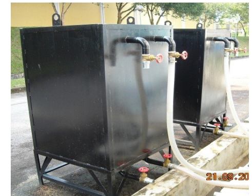
(d) Ballast water tanks
