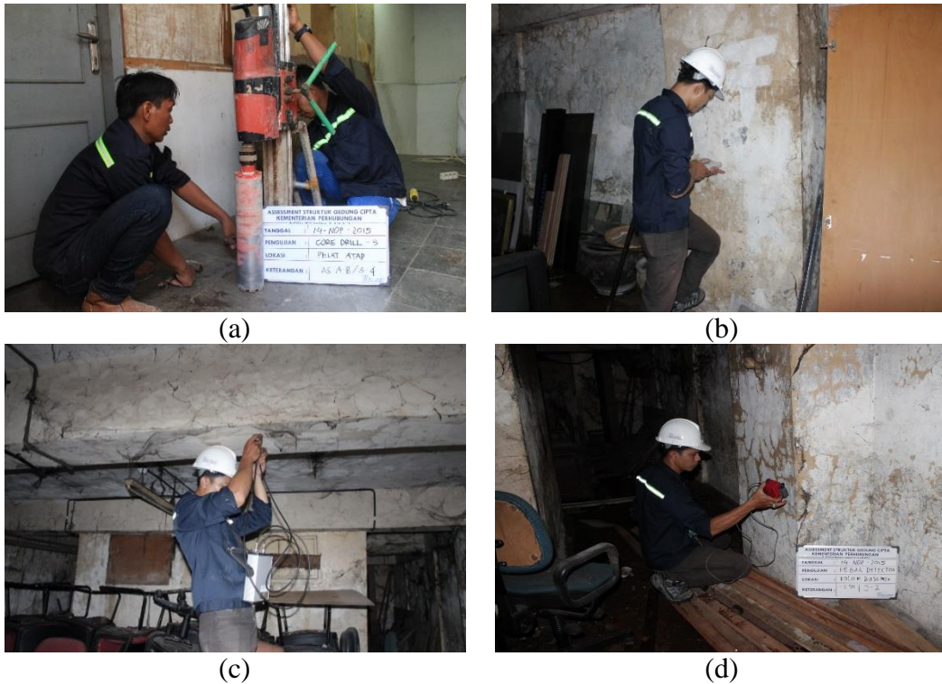
Gambar 3. (a) Tes pengambilan inti beton ; (b) Tes hammer ; (c) Tes ultrasonic ; (d) Tes Rebar Locator
