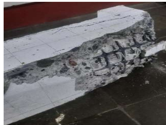
Gambar 5. Pola Retak Spesimen Kolom ANC
