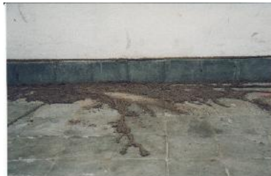
Gambar 5. Salah satu petunjuk serangan rayap pada bangunan
