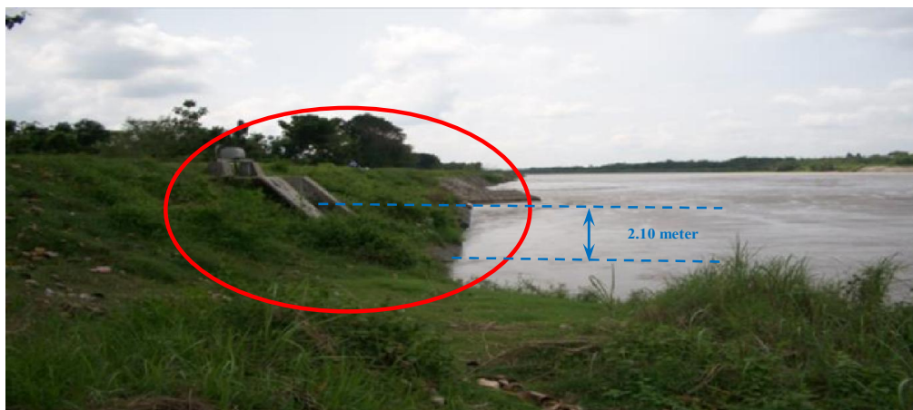
Gambar 5. Foto Posisi Intake Saluran Irigasi Gedek Dari Kali Brantas Tahun 2012 Dalam Kondisi Banjir
