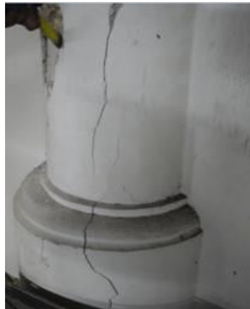
Gambar 6. Kondisi Kolom Mengalami Retak Struktural
