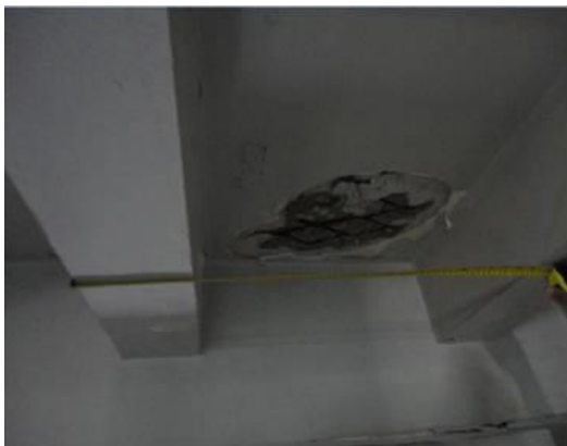
Gambar 5. Kondisi Pelat Lantai yang Mengalami Pelapukan akibat Korosi pada Tulangan
