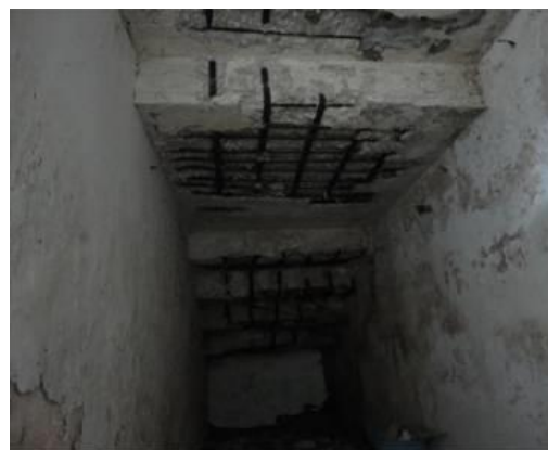
Gambar 7. Kondisi Pelat Tangga yang Mengalami Pelapukan
