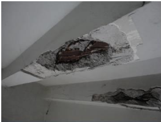
Gambar 4. Kondisi Balok Anak yang Mengalami Pelapukan akibat Korosi pada Tulangan
