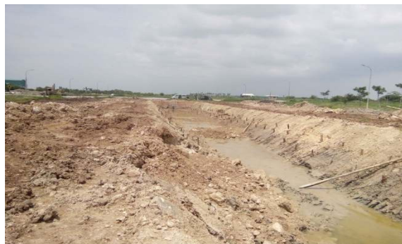
Gambar 2. Kondisi kelongsoran lereng
