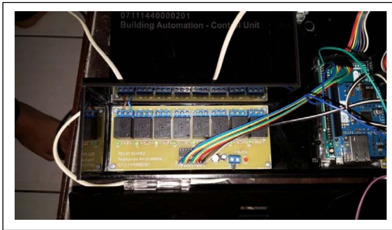
Gambar 2. Relay pada unot kontrol di perangkat otomasi bangunan Sumber: Dokumentasi Penulis (2018)
