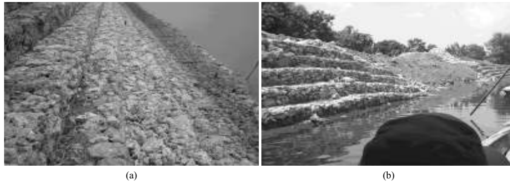
Gambar 1: (a) Pembangunan tanggul sungai bengawan solo di desa Widang. (b) Kelongsoran tanggul terjadi setelah tanggul berumur kurang dari dua bulan
