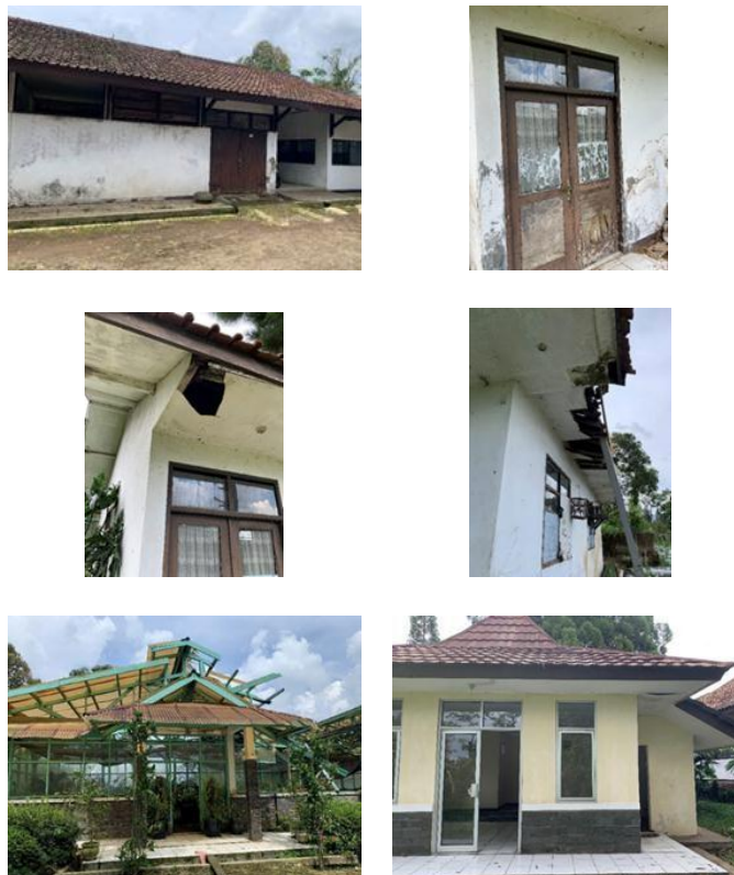
Gambar 2. Kondisi Bangunan Satpel BBH Margahayu Lembang
