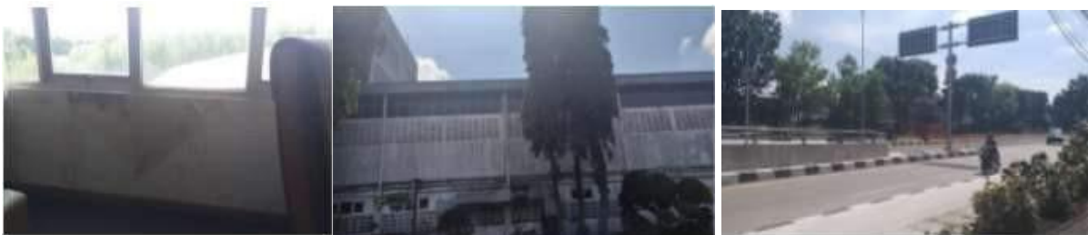
Gambar 1. Permasalahan Eksisting Bangunan
