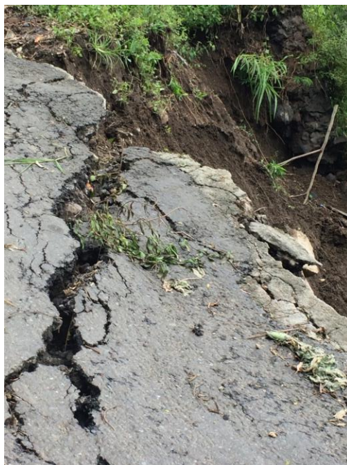
Gambar 6. Runtuhnya Dinding Penahan Tanah
