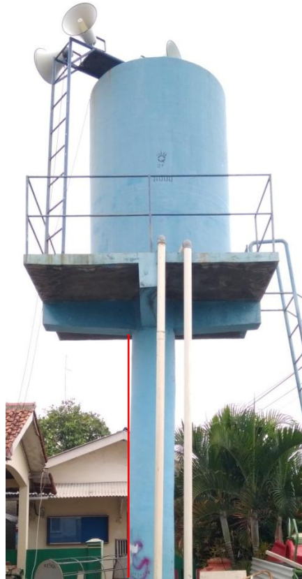
Gambar 2. Kondisi Struktur Tandon Air Eksisting (Sumber: gambar dokumen pribadi)
