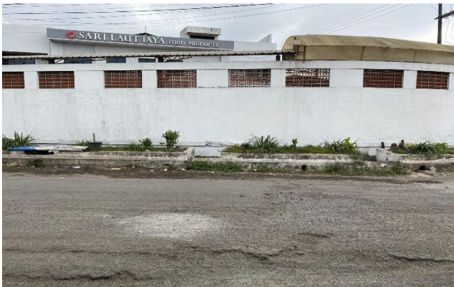
Gambar 2 Jaringan Jalan yang Rusak dan Berlubang
