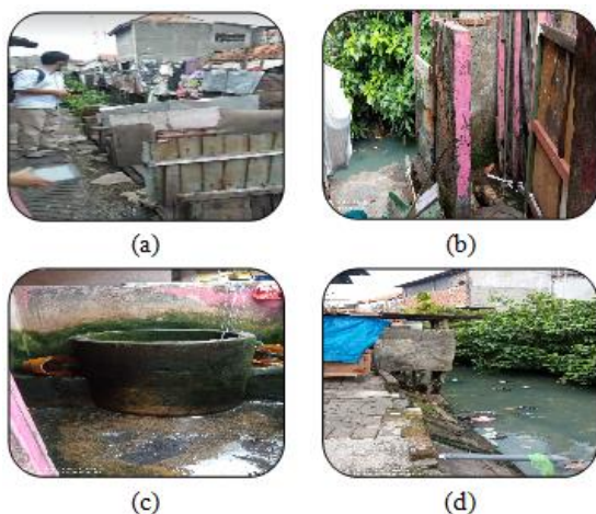
Gambar 4. Kondisi Existing Sanitasi di RW 01 Kelurahan Sidotopo.
