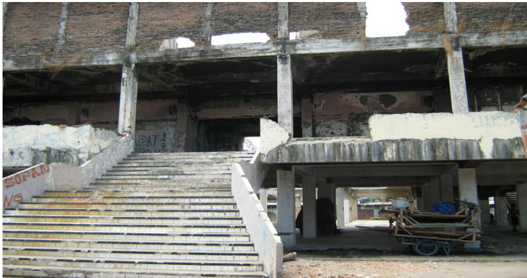
Gambar 1 Contoh Tanah dan Bangunan Yang Telantar (Lokasi Surabaya)
